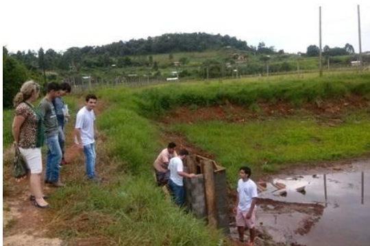
Fig. 1 – Adequação da estrutura de drenagem do viveiro para cultivo de peixes na comunidade Sede.
