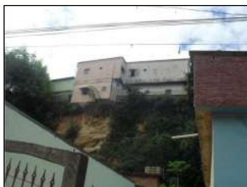
Figura 5: Moradora destaca que em sua casa as pedras rolam somente até a horta, mas que na vizinha elas atingem a porta da cozinha. Para moradora sua casa não está em área de risco.
