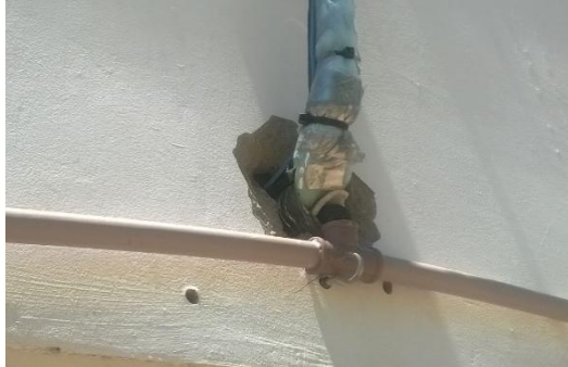
FIGURA 3: Sistema de coleta da água condensada com tubos de PVC.
